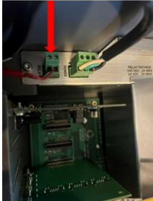
Figura 3-8: Ubicación del relé R7 que muestra el cable de sobrellenado GM conectado en los terminales R7
