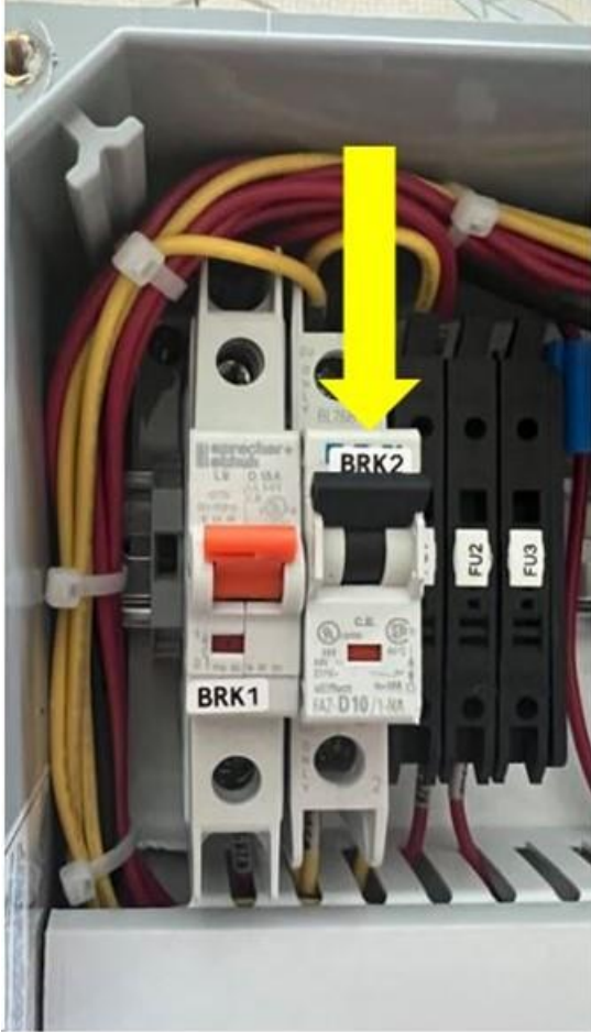
Figura 9-4: Disyuntor de apagado de derivación del dispensador (BRK2) en la posición ARRIBA (CERRADO) durante el mantenimiento.
