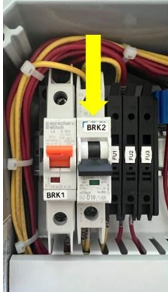
Figura 9-5: Disyuntor de apagado de derivación del dispensador (BRK2) en la posición ABAJO (ABIERTO) durante el mantenimiento.
