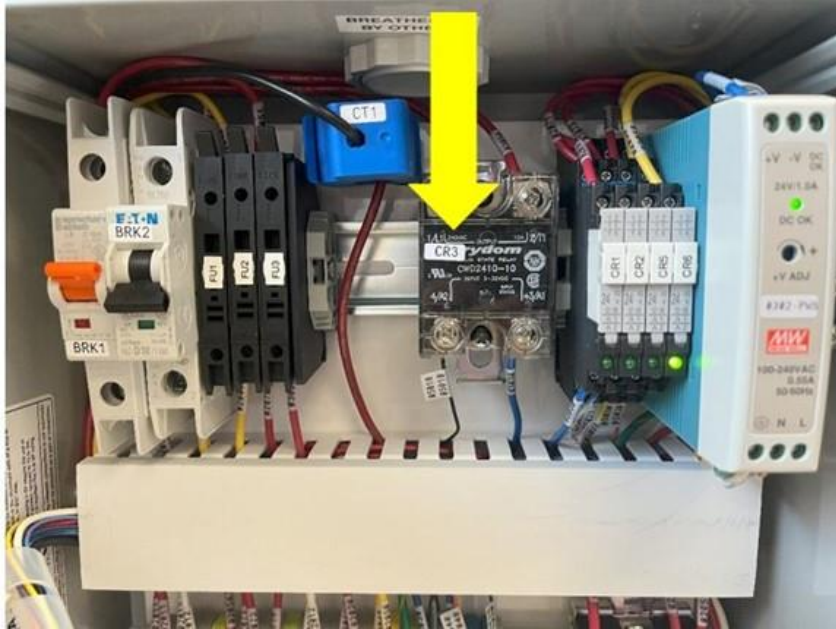
Figura 9-6: Relé de estado sólido de la bomba de vacío
