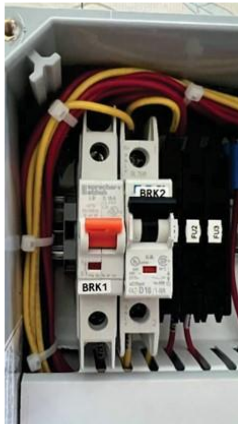
Figura 6-3: Posiciones de los disyuntores del panel de control para realizar mantenimiento en la GREEN MACHINE
