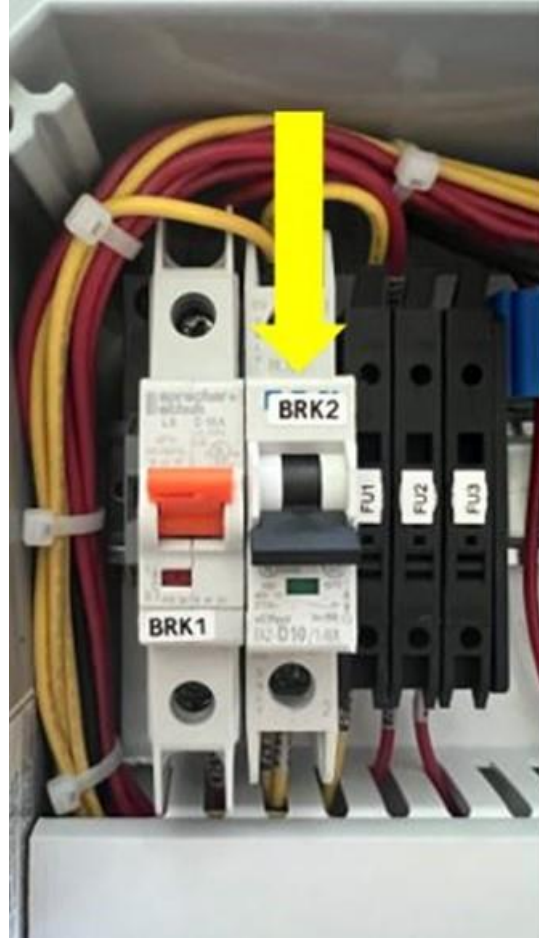
Figura 9-5: Disyuntor de apagado de derivación del dispensador (BRK2) en la posición ABAJO (ABIERTO) durante el mantenimiento.
