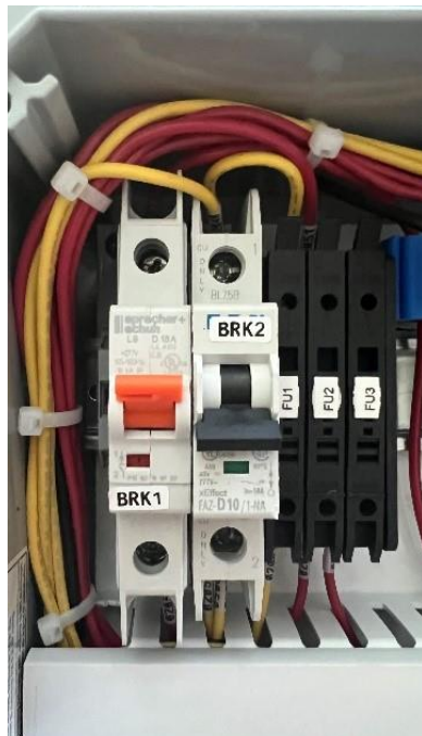
Figura 8-21: El disyuntor de apagado de derivación del dispensador (BRK2) está ABAJO (ABIERTO)
