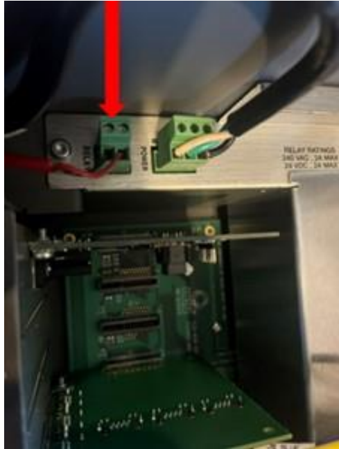
Figura 3-8: Ubicación del relé R7 que muestra el cable de sobrellenado GM conectado en los terminales R7
