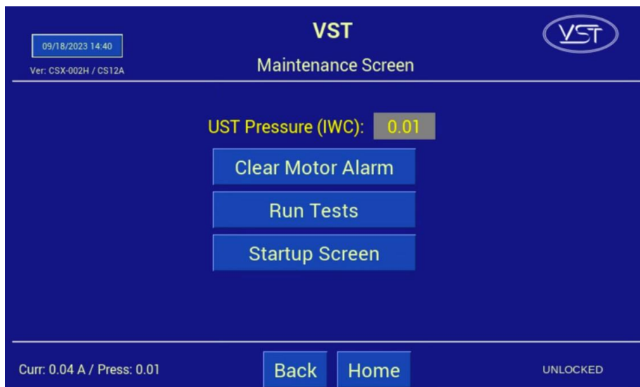
Figura 7-3: Pantalla de mantenimiento
