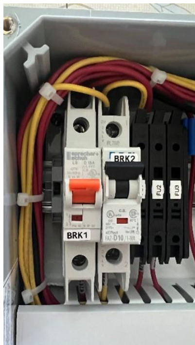
Figura 8-19: El disyuntor de apagado de derivación del dispensador (BRK2) está ARRIBA (CERRADO)
