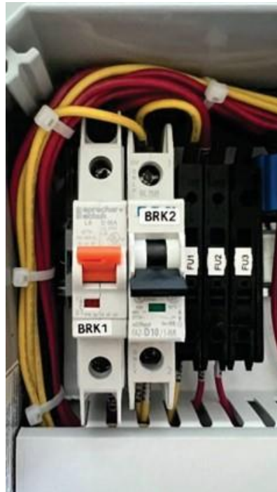
Figura 6-2: Posiciones de los disyuntores del panel de control para el funcionamiento adecuado de la estación
