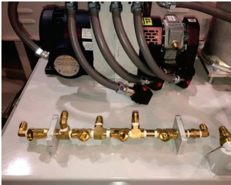
Figura 9-31: Solenoides (con las bases para solenoides instaladas) acomodados y apartados
