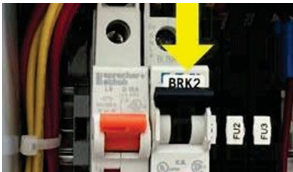
Figure 3-9: Disyuntor de apagado de derivación del dispensador (BRK2) en la posición ARRIBA (CERRADO)
