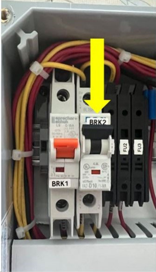
Figure 9-4: Disyuntor de apagado de derivación del dispensador (BRK2) en la posición ARRIBA (CERRADO) durante el mantenimiento.
