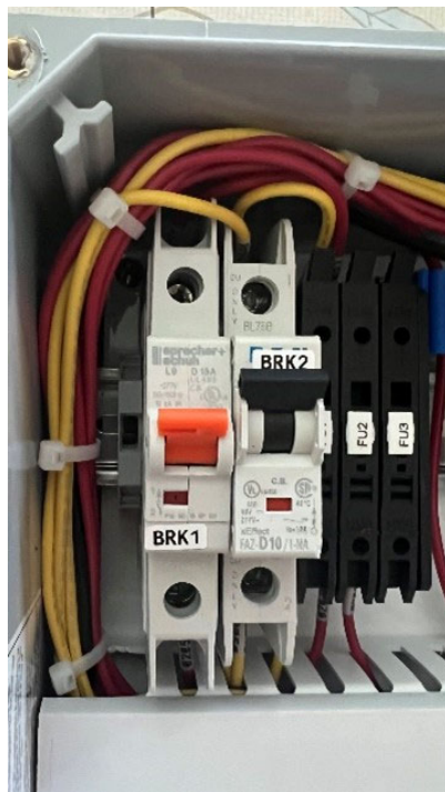
Figure 8-19: El disyuntor de parada de derivación del dispensador (BKR2) está arriba (cerrado)
