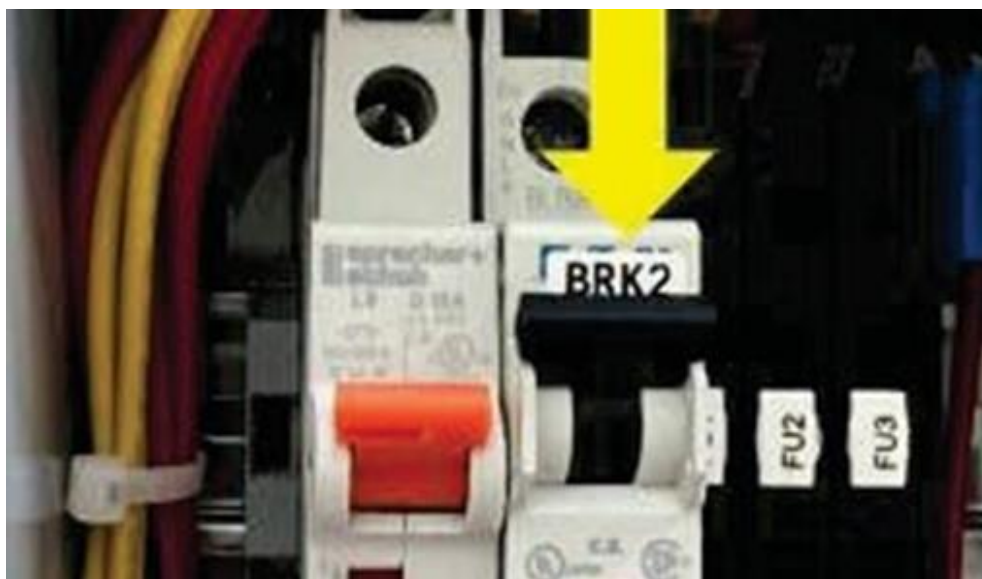
Figure 3-9: Disyuntor de apagado de derivación del dispensador (BRK2) en la posición ARRIBA (CERRADO)
