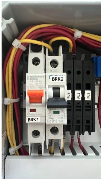
Figure 8-21: Disyuntor de apagado de derivación del dispensador (BRK2) en posición bajada (ABIERTO)
