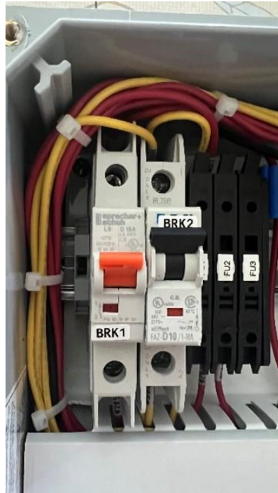
Figure 8-19: El disyuntor de parada de derivación del dispensador (BKR2) está arriba (cerrado)
