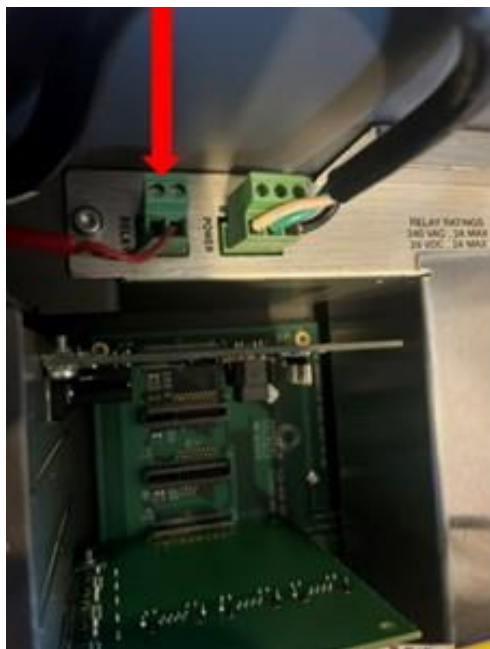
Figure 3-8: Ubicación del relé R7 que muestra el cable de sobrellenado GM conectado en los terminales R7
