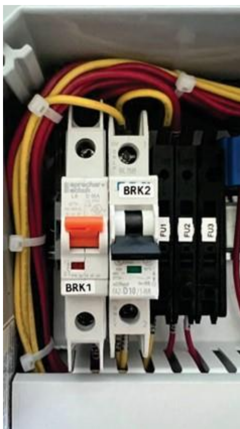
Figure 6-2: Panel de control Posiciones del disyuntor para el funcionamiento adecuado de la estación
