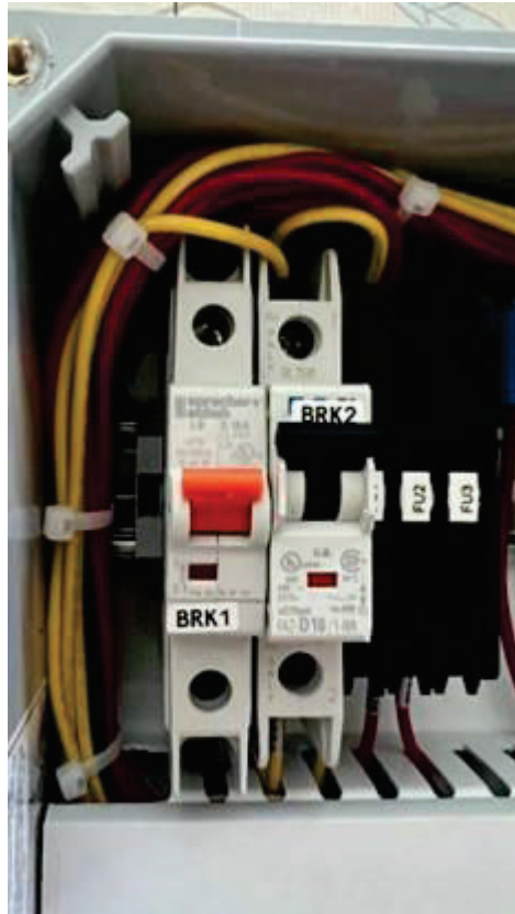
Figure 6-3: Panel de control Posiciones de disyuntores para realizar el mantenimiento de la GREEN MACHINE
