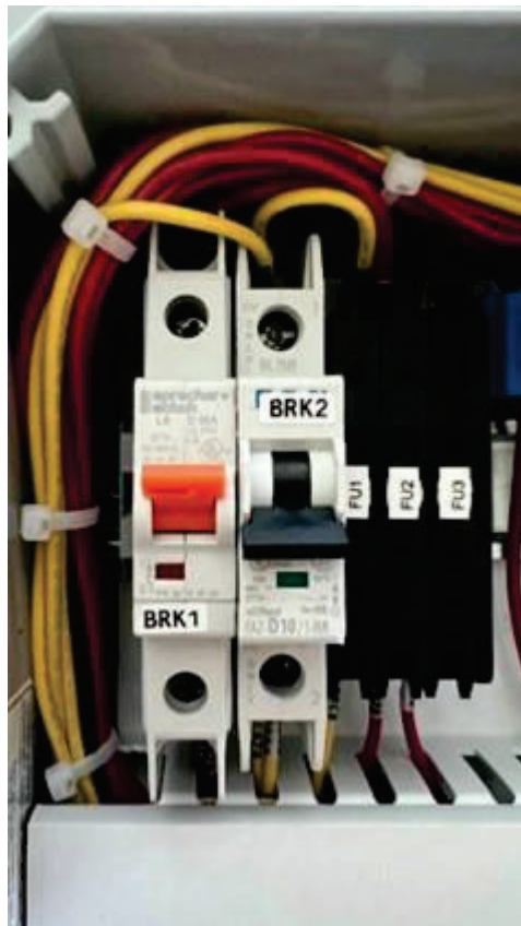
Figure 6-2: Panel de control Posiciones del disyuntor para el funcionamiento adecuado de la estación
