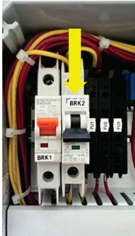
Figure 9-5: Disyuntor de apagado de derivación del dispensador (BRK2) en la posición ARRIBA (CERRADO) durante el mantenimiento.
