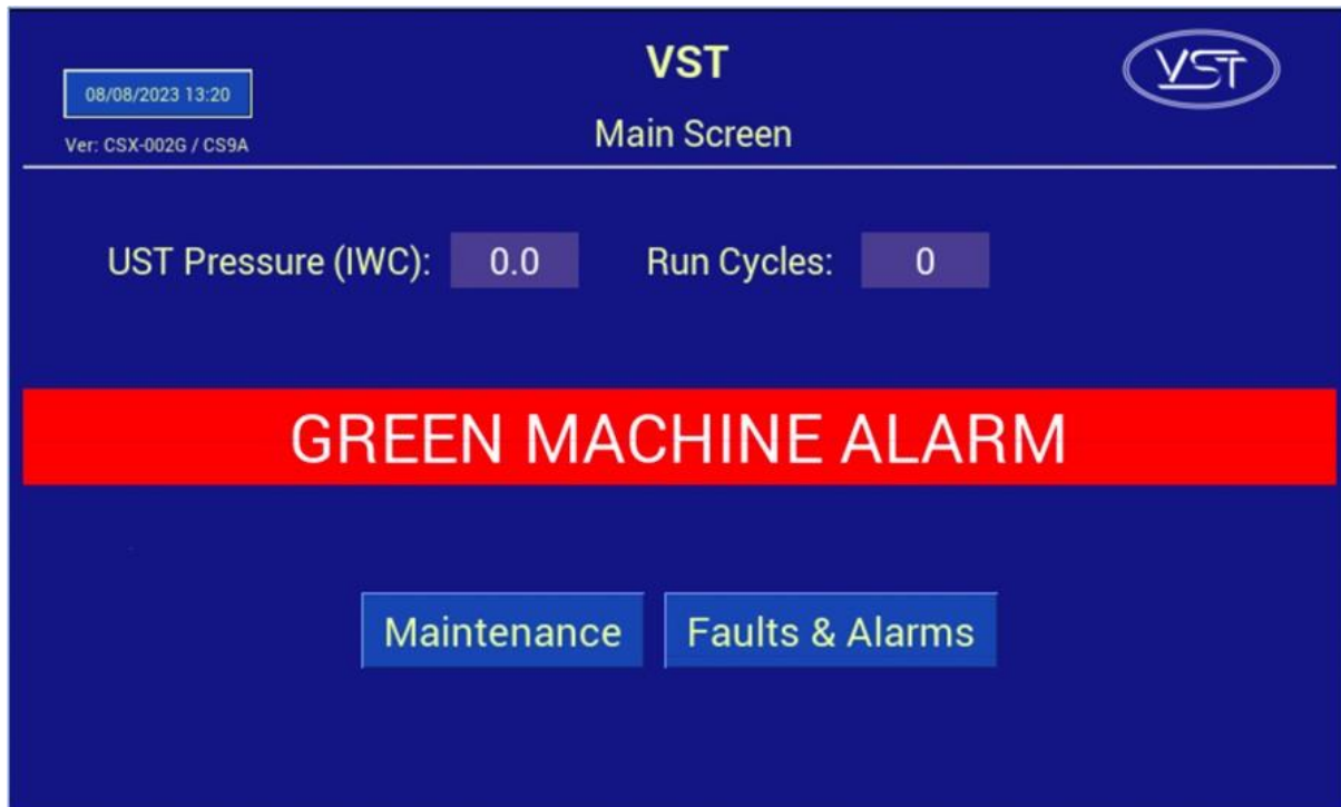
Figura 8-2: Pantalla principal del panel de control del GREEN MACHINE de VST con una alarma activa
